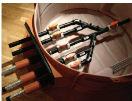
▲ Ny fordelingskum for stikkledninger.
